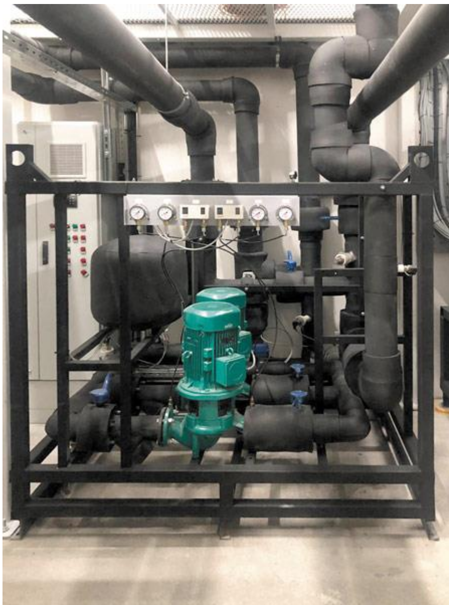
Рис. 1.30 Насосна станція хладоносителя для виробничих приміщень
