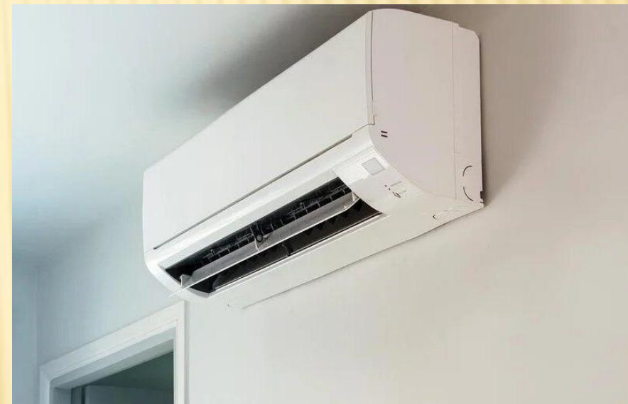
Внутрішній блок настінного кондиціонера в номері готелю
