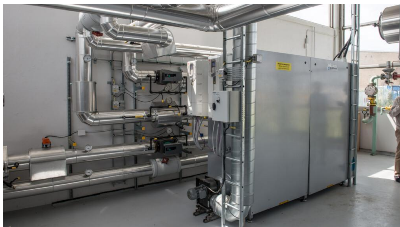
Рисунок 4. Загальний вигляд теплового насоса вода-вода [21]
