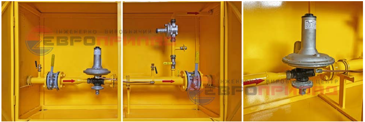
Рисунок 2.7 – Шафовий газорегуляторний пункт ШРП-1-1500-0,3
