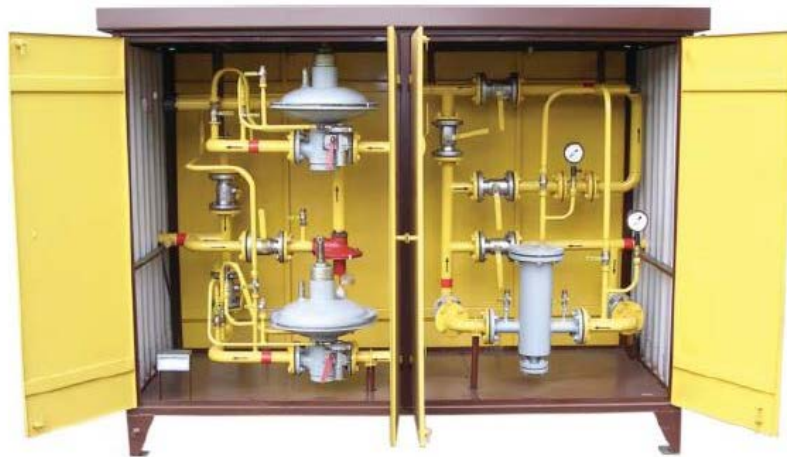
Рисунок 2.4 – Загальний вигляд шафового газорегуляторного пункту (ГРПШ, ШРП)
