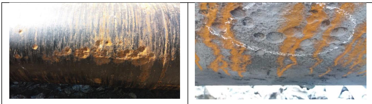
Рис. 3.3 – Корозійні пошкодження магістральних газопроводів.
