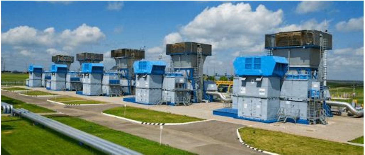
Рис. 2.3 - Загальний вигляд - газоперекачувальний агрегат ГПА-Ц-16.
