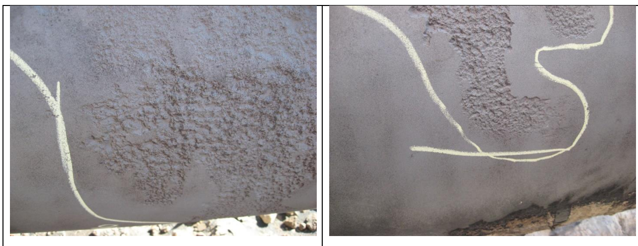
Рис. 3.5 – Дефекти матеріалу трубопроводу (виразкова корозія).
