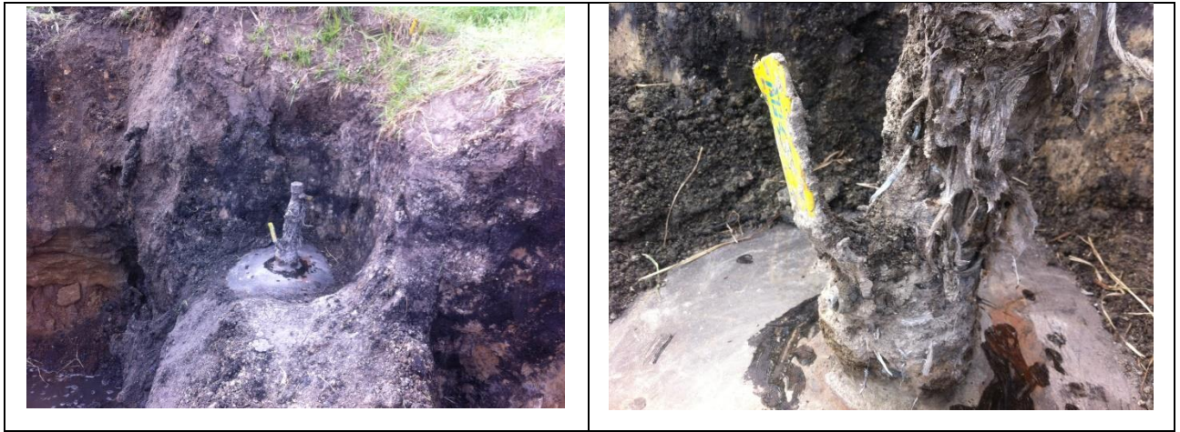
Рис. 3.6 – Несанкційна врізка у трубопровід.
