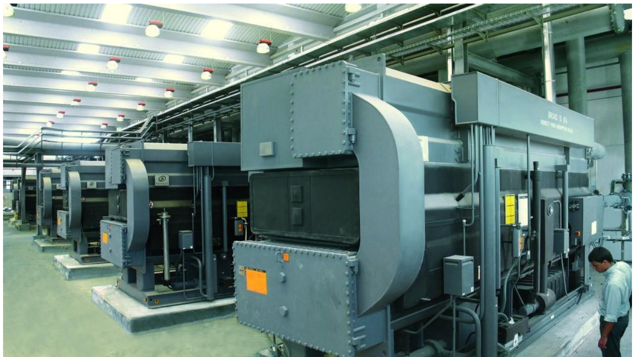
Рис. 2.9 - Типовий вид сучасного машинного холодильного залу з системою абсорбційних бромистолітієвих холодильних машин.
