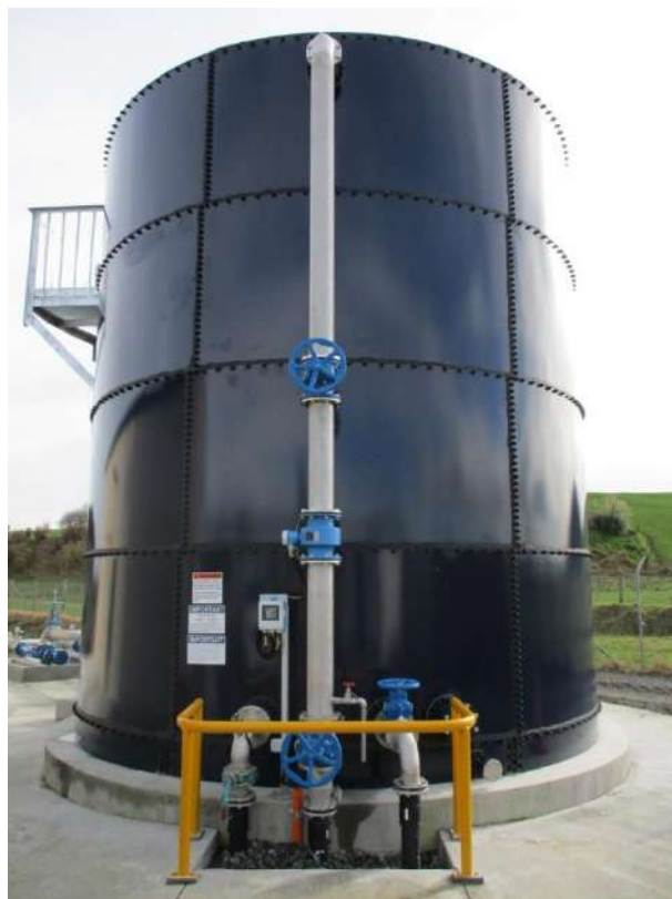
Рисунок 21 – Резервуар для проміжного зберігання олії CST Bolted Steel Tank
