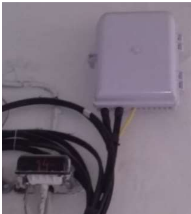
Рисунок 1.7. Бокс ONU/ONT на сходах четвертого поверху
