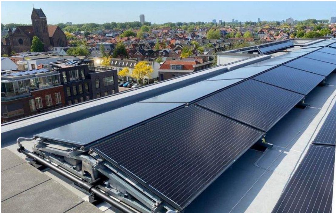
Рисунок 1.17. Конструкція гібридного модуля Triple Solar M3, встановлена на даху
