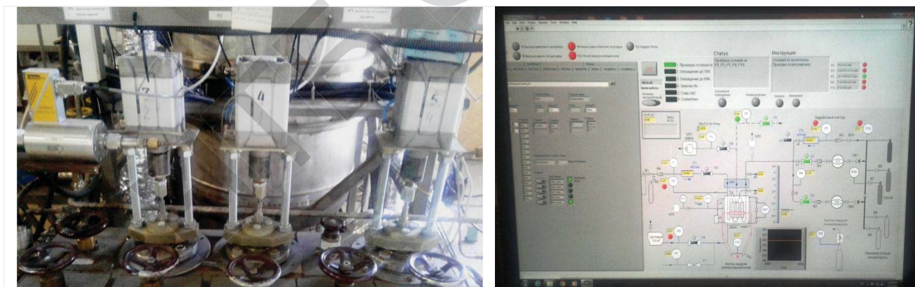
Рис.4. Блок пневмо керування приводів криогенної арматури і інтерфейс оператора (праворуч).
