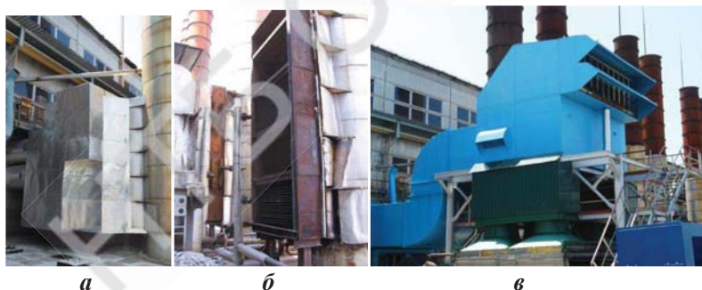
Рис. 1.4. Водогрійні утилізаційні котли – економізатори в газовипускному тракті ГТУ ГТК-10-4 на Південно-Бузькій компресорній станції (м. Південно-Українськ, Миколаївська обл.): a – загальний вигляд; б – трубчасті секції котла; в – впускний тракт забору зовнішнього повітря та газовипускні труби газотурбокомпресора ГТК-10-4
