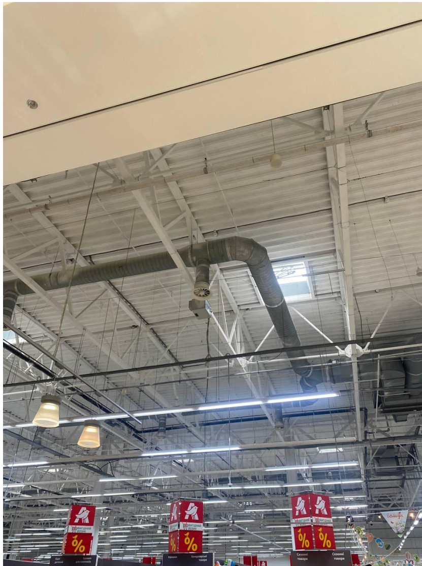
Рисунок 1.2 - Торговий зал ТРЦ «Рів'єра» зі стельовими повітроводами та вентиляційними дифузорами
