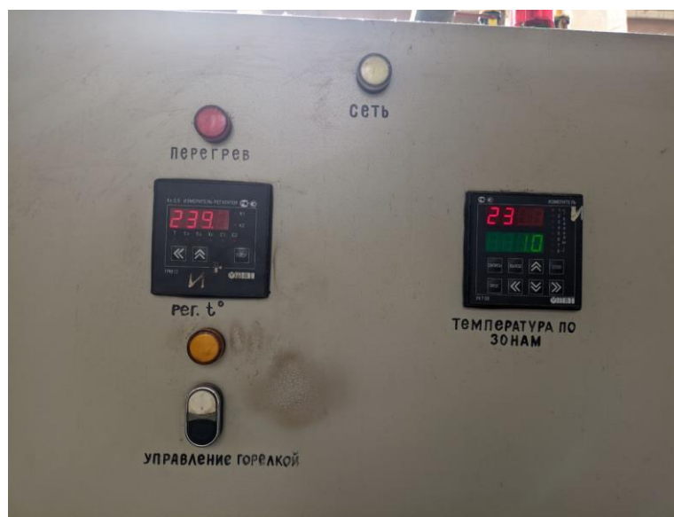
Рисунок 1.7 - Змонтовані на щиті прилади для керування ТП
