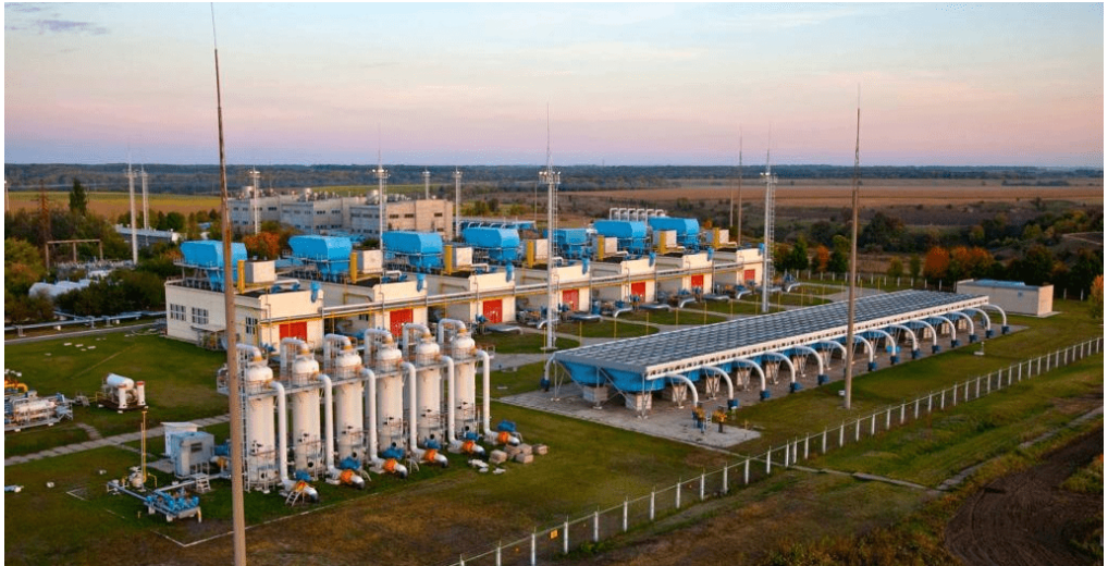
Рисунок 1.6 - Компресорна станція “Гусятин”
