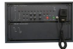
Комплекс мовного оповіщення про пожежу
