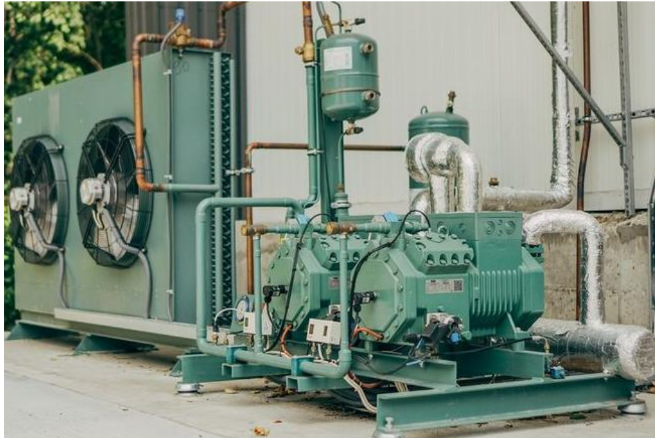
Рис. 1.11 Холодильна установка промислового овочесховища
