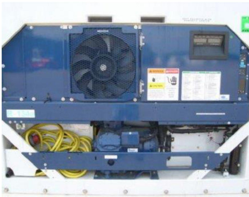
Рис. 2.2. Холодильне обладнання контейнера.
