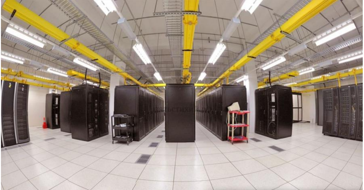
Рис.5.3 - Освітлення серверного приміщення
