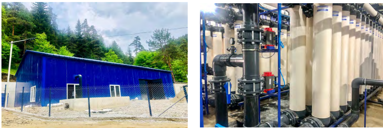
Рис. 3.12 – Будівля та обладнання цеху ультрафільтраційного очищення
