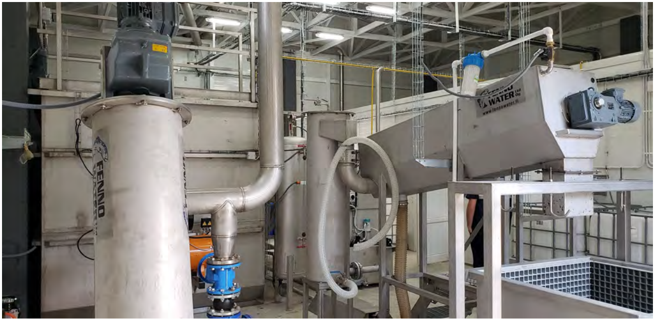
Рис. 3.8 – Цех очищення стічних вод заводу № 2 «Боржомі»
