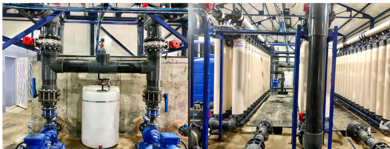
Рис. 3.13 – Обладнання цеху ультрафільтраційного очищення (1)
