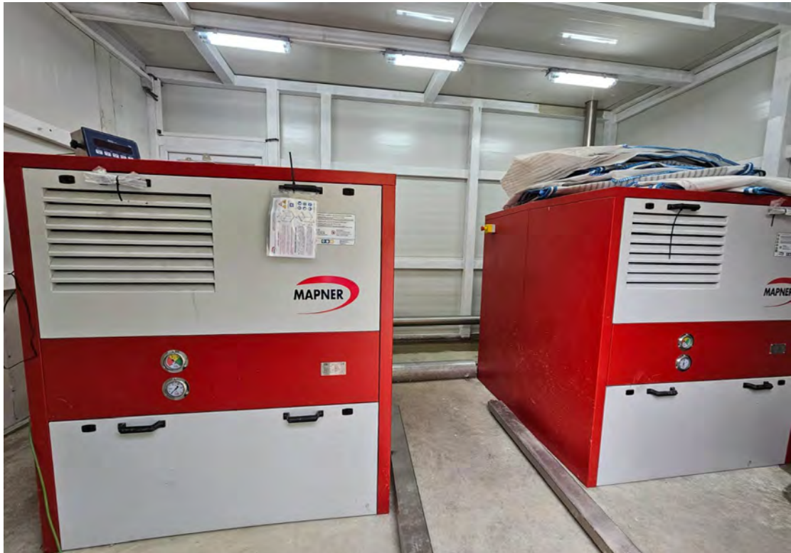
Рис. 3.6 – Контролююче обладнання системи очищення стічних вод заводу №2 «Боржомі»
