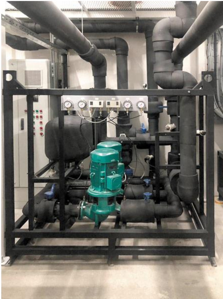
Рис. 1.30 Насосна станція хладоносителя для виробничих приміщень
