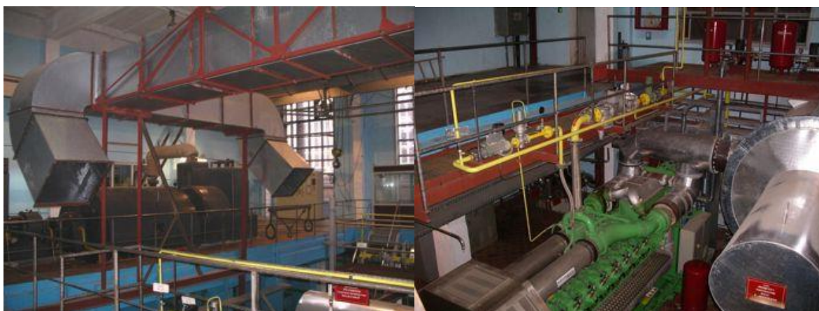
Рис.1.8. Машинное отделение когенерационной энергетической установки на базе газовых двигателей GE Jenbacher суммарной мощностью 3,4 МВ с направленной приточной вентиляцией воздуха (ОАО "Смелянский сахарный комбинат", г. Смела)
