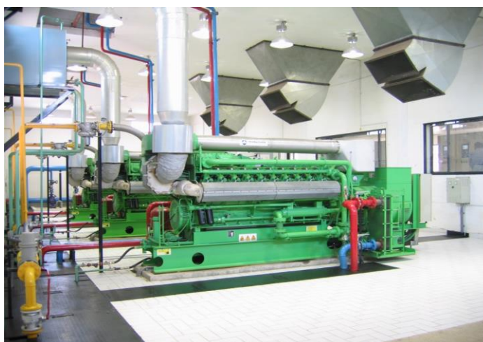
Рис.1.7. Машинное отделение с направленной системой вентиляции [18]
