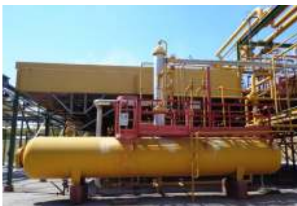
Рис. 1.5. Внешний вид линейного ресивера D-4B, обеспечивающего приём жидкого аммиака высокого давления из двух секций конденсатора E-1C и E-1D
