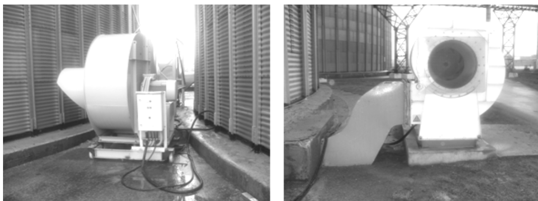
Рис. 4 – Підключення вентиляторів для активного вентиляції металевих силосів
